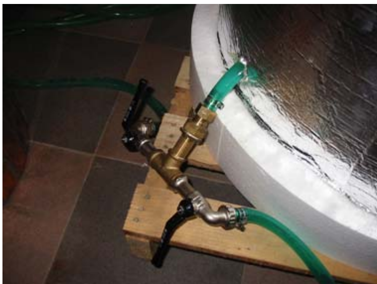
Fig. 18 – Tubazioni di carico/scarico del corpo nero
